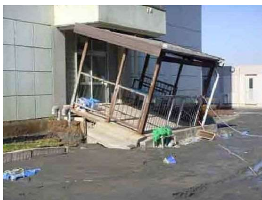
ポーチの沈下(平成 23 年度浦安市液状化対策技術検討調査報告書より)
