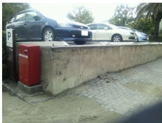
駐車場ピットの浮き上がり
