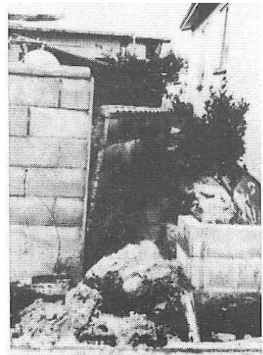
(横筋のないブロック塀の隅角部での分離 向う側の塀は沈降、傾斜している。)
