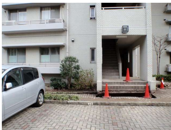
建物周囲の地盤沈下
