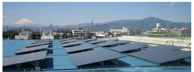
太陽光発電設備 (相模川流域下水道 四之宮水再生センター)
