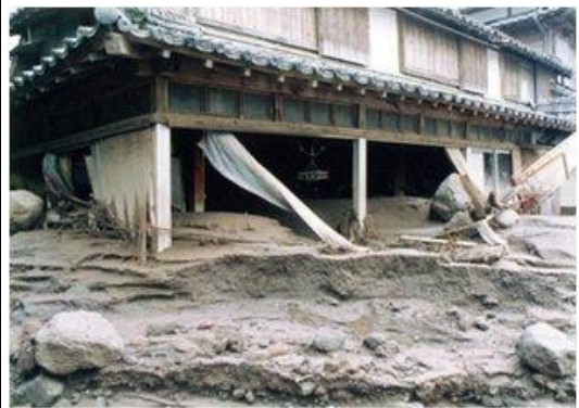
土石流被害を受けた家屋 国土交通省九州地方整備局雲仙復興事務所提供
