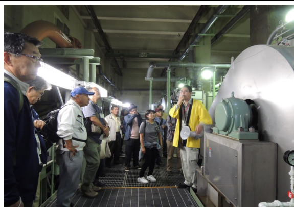
汚泥焼却施設
