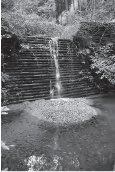
写真2 ヌタノ沢 A 沢の出水後の堆砂
