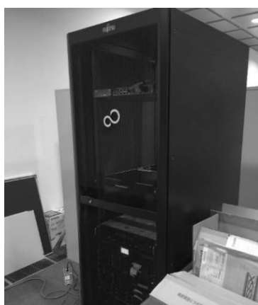
写真7 データベースを保持しているサーバールーム内のサーバー
