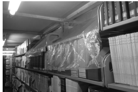
写真6 4階書庫の天井と書籍の状況
