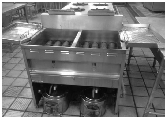
写真 12 ガスフライヤー
