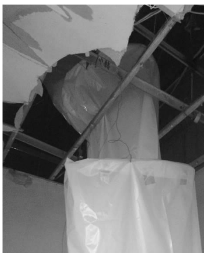
写真11 地階講堂の雨漏り（応急処置後）
