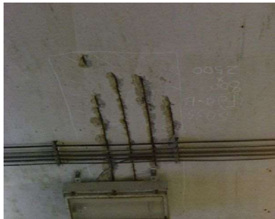
付写真-2.2 鋼材腐食の例
