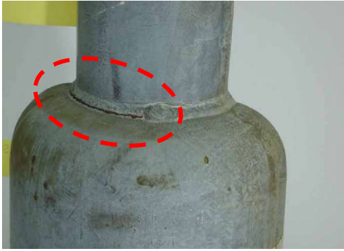
照明柱断面変化部の溶接に確認された亀裂 (歩道橋、15年経過)
