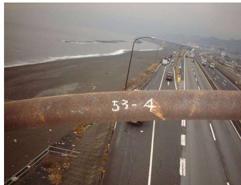
写真-解 8-10 支柱本体の腐食事例
