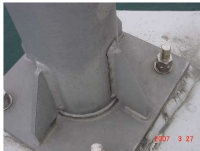
標識柱基部溶接部の亀裂
