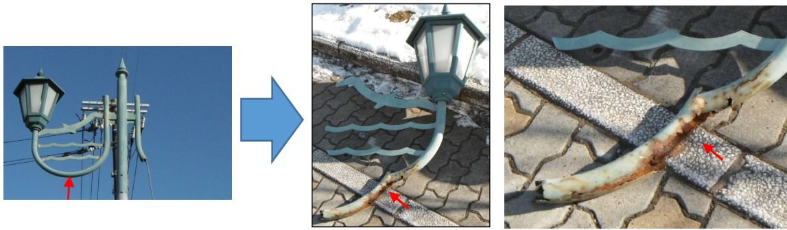
写真-解 3-1 特徴的な部分の腐食が進行した例
