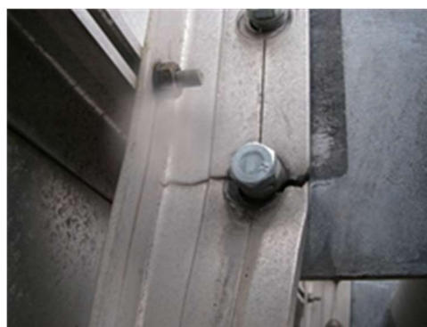
取付部の変状状況
