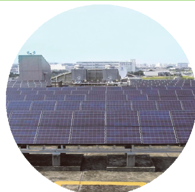
県総合防災センター屋上の太陽光パネル
