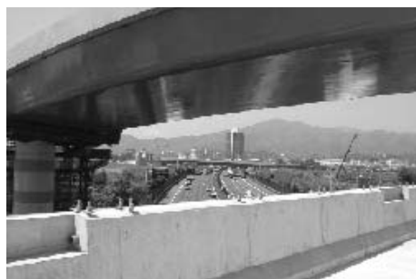
施工中のさがみ縦貫道路海老名北ジャンクション（仮称） （東名高速道路を跨ぐさがみ縦貫道路本線を前方に望む）
