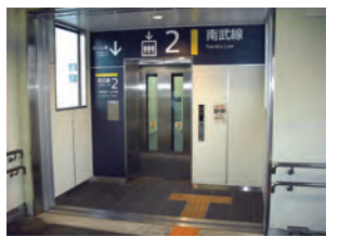
駅舎に設置したエレベーター
