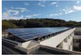
横浜栄高等学校に設置した太陽光発電設備
