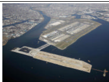
羽田空港D滑走路工事全景 (2010年3月撮影) (提供：羽田再拡張D滑走路JV)
