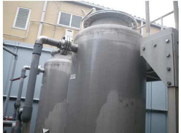
地下水汚染対策（秦野市 浄化施設）
