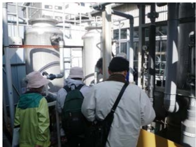
地下水保全対策の推進（秦野市水道局）
