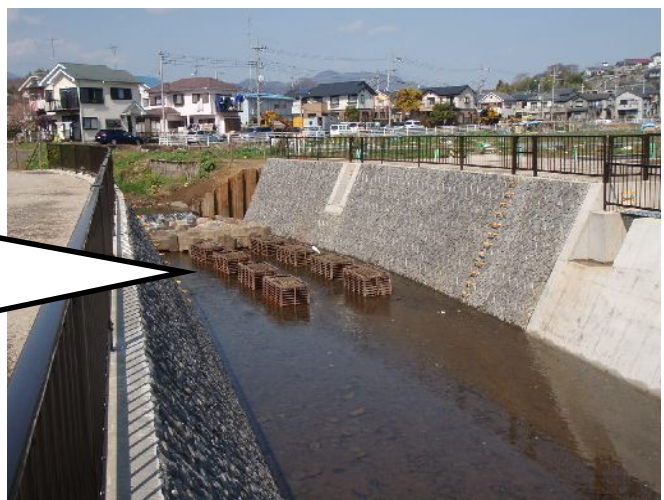
厚木市 恩曾川 水質浄化ブロック
