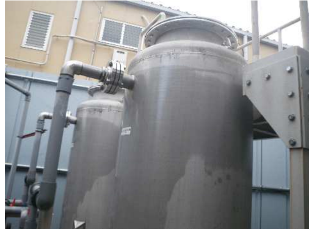
地下水汚染対策（秦野市 浄化施設）
