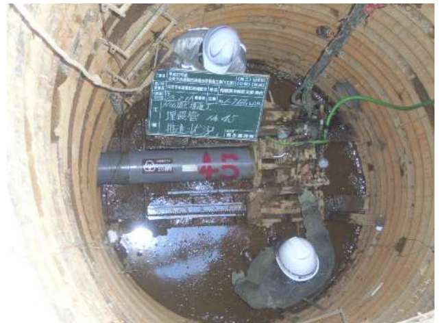
推進工法（道路を開削せず、トンネル状に掘削した穴に管を通す工法）による管の敷設
