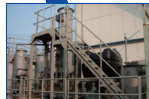
地下水浄化施設(秦野市)
