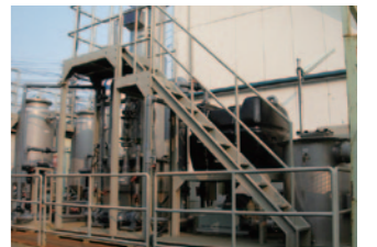
地下水を浄化する施設
