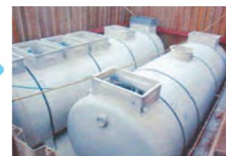
高度処理型合併処理浄化槽
