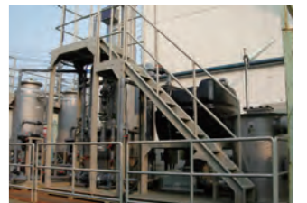
地下水を浄化する施設
