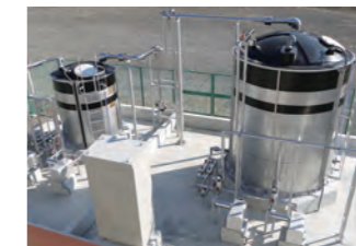
桂川清流センターのリン除去設備(山梨県大月市)
