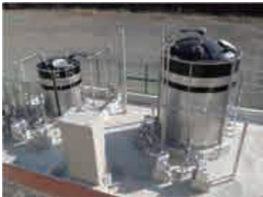
山梨県大月市にある桂川清流センター内に、リン除去設備を設置した。
