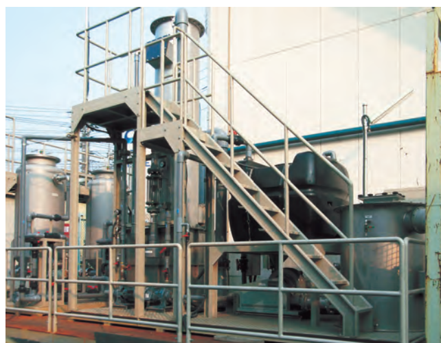
地下水浄化設備（秦野市）
