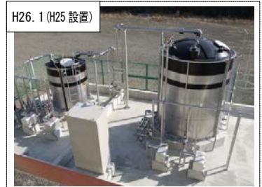
H26. 1 (H25 設置) ⑩相模川水系上流域対策 山梨県内の下水処理場に新たに設置したリンを取り除くための設備を移動した。(山梨県桂川清流センター)
