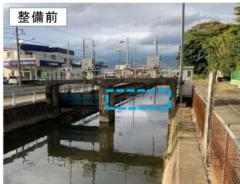
豪雨時の増水により破損した水門
