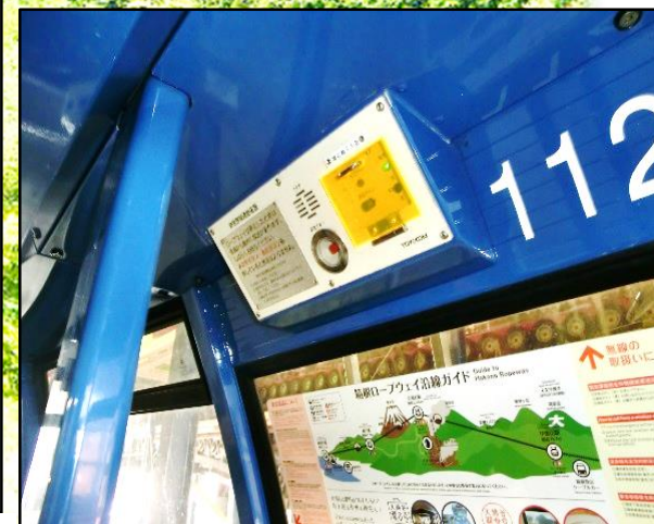
ロープウェイゴンドラ内の通信設備
