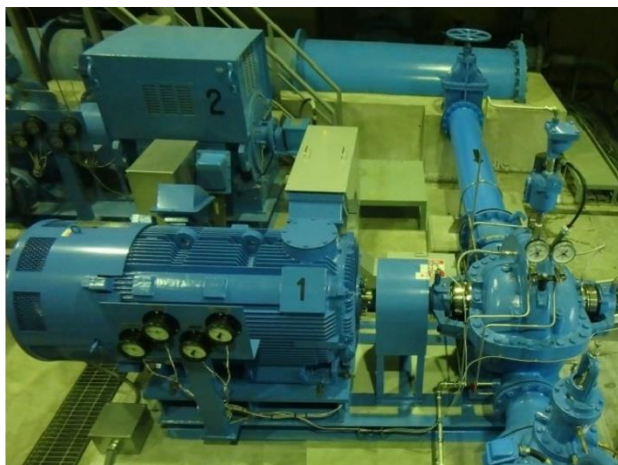
【図18】高効率設備（ポンプ）への更新
