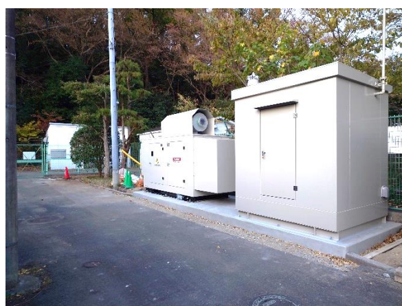
【図 15】 非常用発電設備
