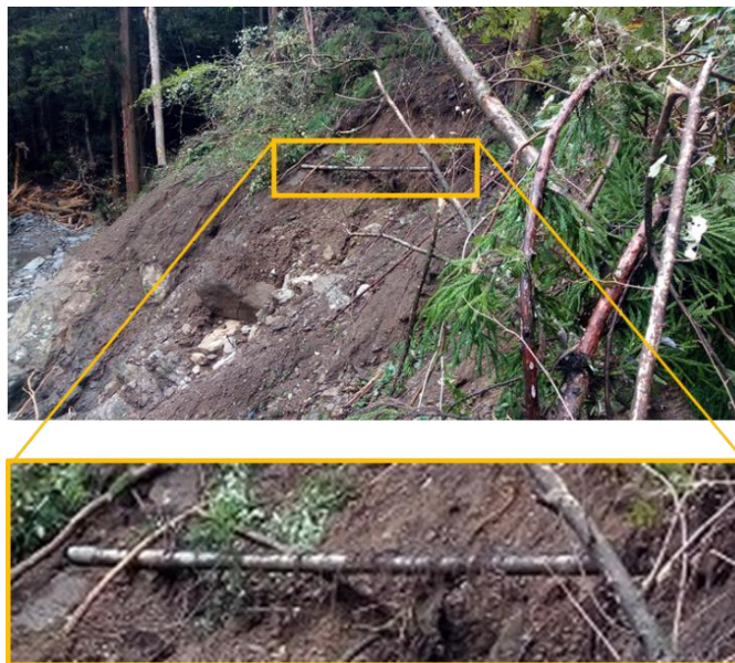
【図19】令和元年台風第19号の被害
