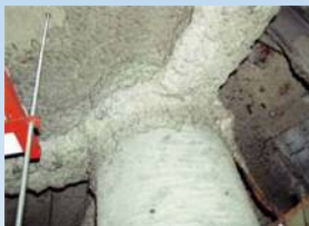
吹付け石綿(レベル1) 鉄骨の耐火被覆
