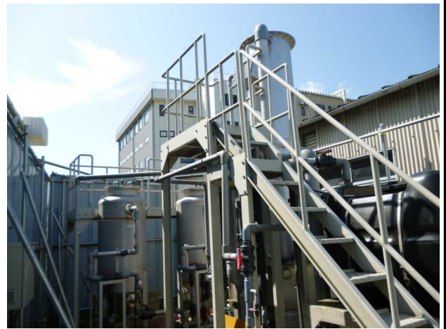
地下水汚染対策 (秦野市 浄化施設)
