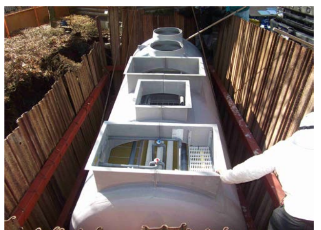
公衆トイレの高度処理型浄化槽(25人槽)をクレーンで所定の位置に据付ける。
