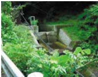
森林モニタリング(対照流域法)のため、新たに整備した流量を観測する施設。
