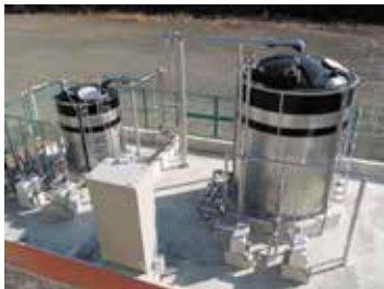
山梨県大月市にある桂川清流センター内にリン除去設備を設置した。
