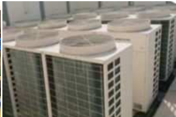
空調設備（藤沢水道営業所）
