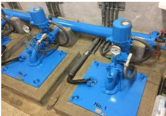
ポンプ設備（善波揚水ポンプ所）
