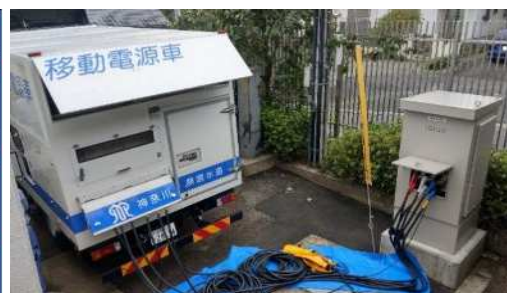
移動電源車に対応した設備
