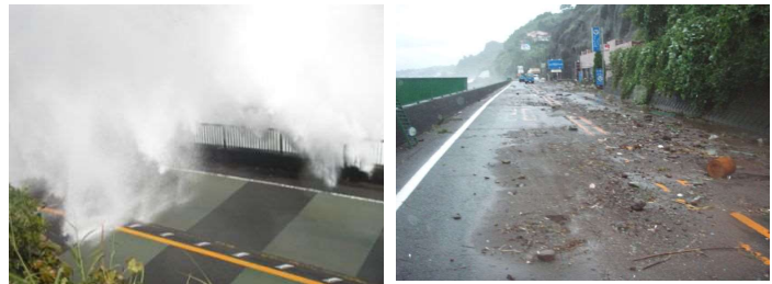
平成19年台風9号による越波被災状況
