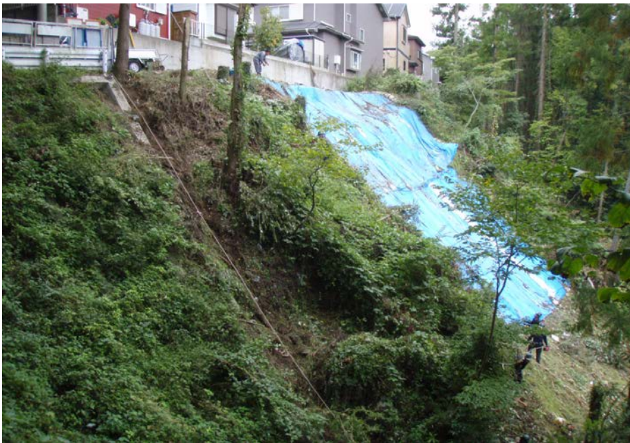
治山事業実施前
