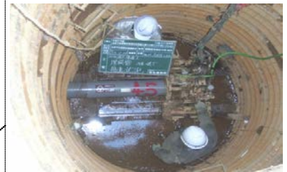
⑧⑨ダム集水域の生活排水対策(下水道・浄化槽) 推進工法(道路を開削せず、トンネル上に掘削した穴に管を通す工法)により管を敷設した。(相模原市緑区)
