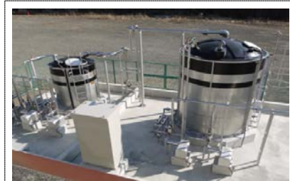
⑩相模川水系上流域対策 山梨県内の下水処理場に新たに設置したリンを取り除くための設備を稼動した。(山梨県桂川清流センター)
