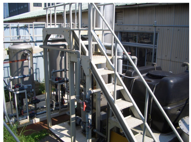
地下水汚染対策(秦野市 浄化施設)
