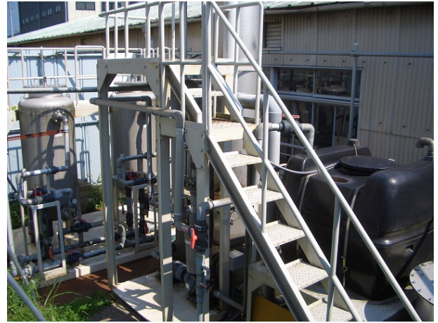
地下水汚染対策（秦野市 浄化施設）
