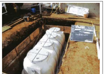
⑧⑨ダム集水域の生活排水対策(下水道・浄化槽) 合併処理浄化槽(7人槽)の整備により、水質改善を図った。(山北町中川)
