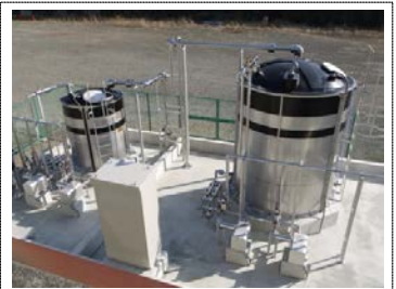
⑩相模川水系上流域対策 山梨県内の下水処理場に、リンを取り除くための設備を新たに設置した。(山梨県桂川清流センター)
