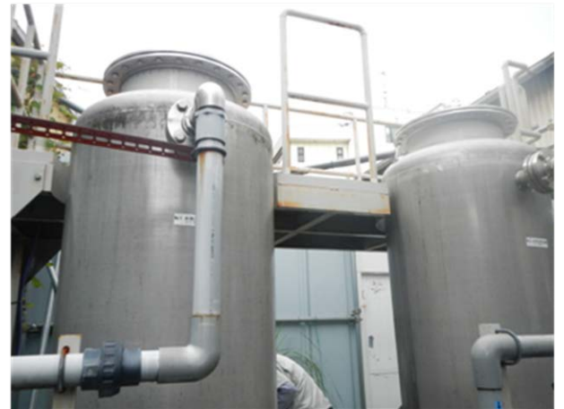
地下水汚染対策（秦野市 浄化施設）
