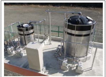
⑩相模川水系上流域対策 山梨県内の下水処理場に新たに設置したリンを取り除くための設備を移動した。(山梨県桂川清流センター)
