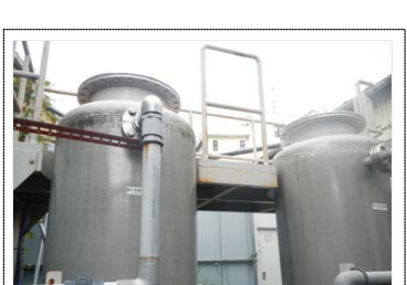
⑦地下水保全対策 有機塩素系化学物質により汚染された地下水を施設の装置に通すことにより水質浄化を図った。(秦野市)
