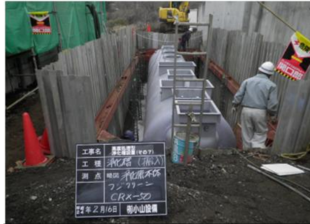
合併処理浄化槽の整備状況
