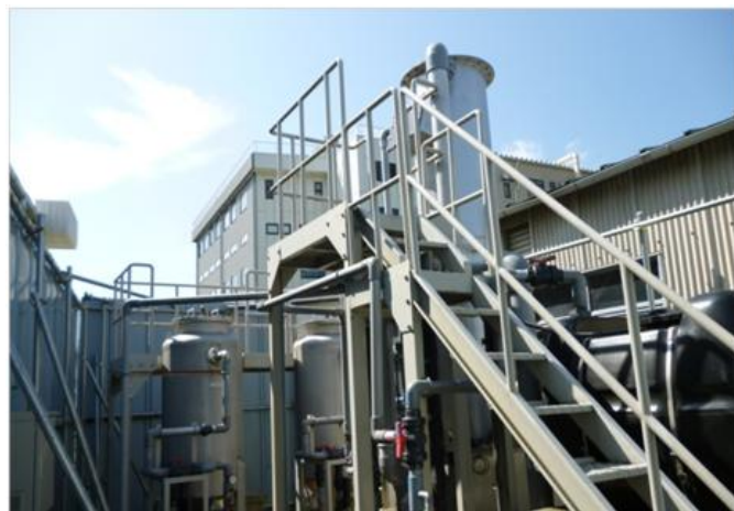
地下水浄化施設
