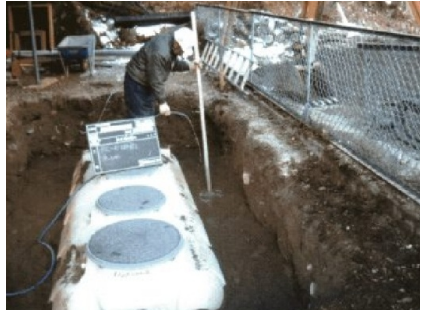
高度処理型合併処理浄化槽
