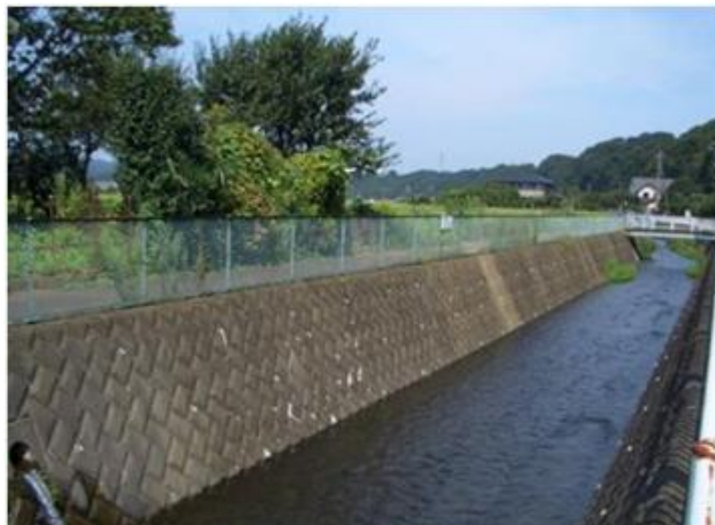
河川整備前の状況
