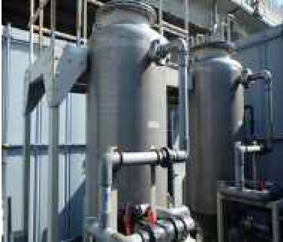
地下水汚染対策（秦野市 浄化施設）
