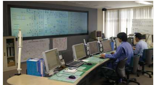
浄水場での遠隔監視制御の様子
