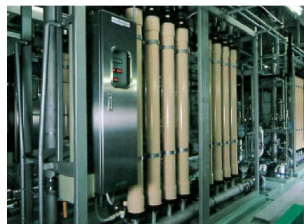
イタリー浄水場の「膜ろ過設備」
