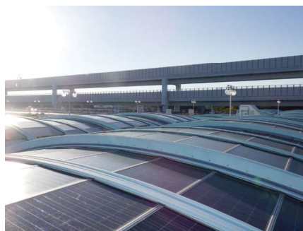
寒川浄水場の太陽光発電
