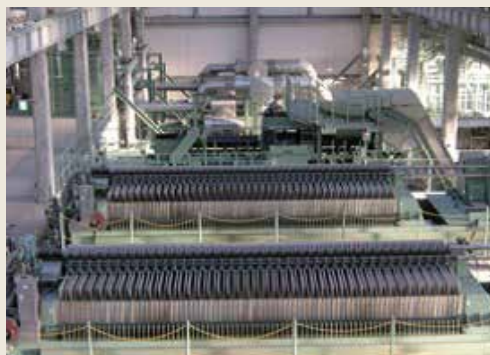
▲排水処理施設
