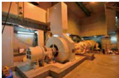
◀愛川第2発電所
