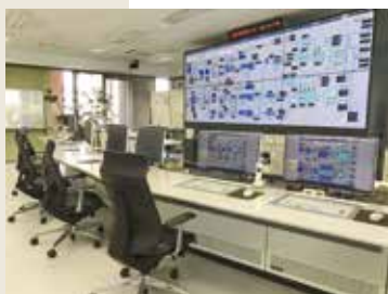
▼寒川浄水場中央監視制御設備
