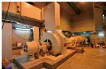
◀愛川第2発電所
