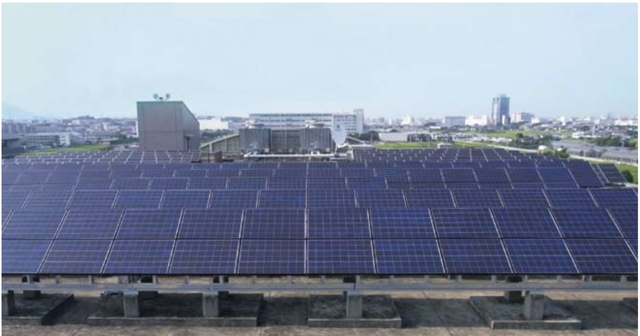
総合防災センターの太陽光発電設備
