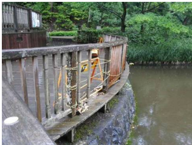
老朽化した転落防止柵（座間谷戸山公園）
