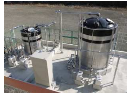
凝集剤添加設備
