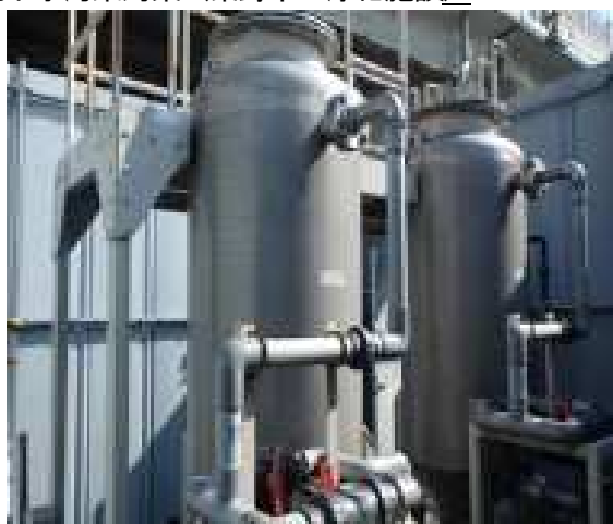
地下水汚染対策（秦野市 浄化施設）
